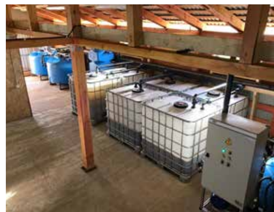
Автоматический растворный узел
